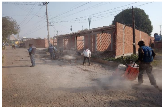
Nota: Fotografía en calle cholula entre 5 de mayo y calle porfirio días en localidad San Sebastian Tepalcatepec en corte de carpeta asfáltica.
