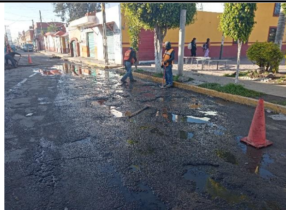
RETRIO DE CARPETA DAÑADA
